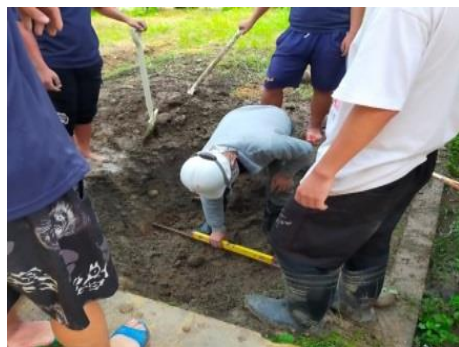
依造水撲滿之高度挖掘土方，並於底部使用水平尺測量，力求平整。
